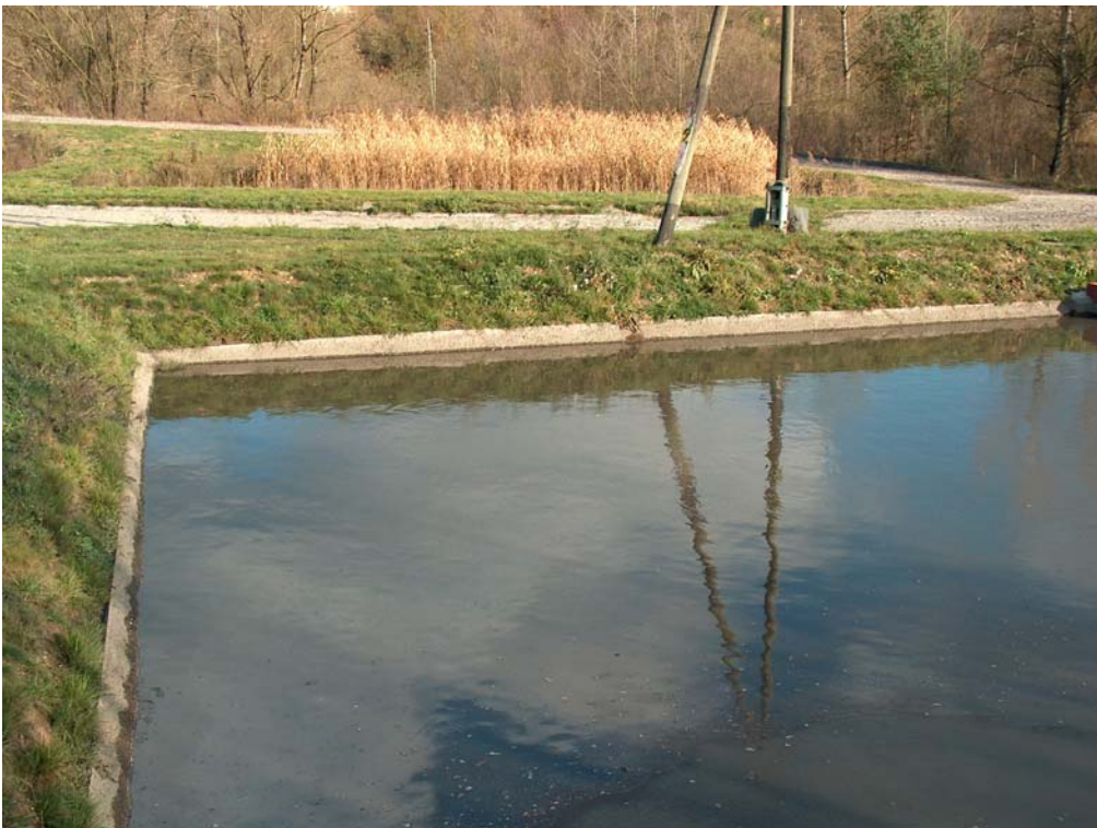
Vordergrund: Speicherteich, Mitte: Kies-Sand-Filter, Hintergrund: Schilfbeet zur Behandlung der Oberflächenwässer und der Abwässer aus der Wischgutaufbereitung 1 (Gunzgen AG, Schweiz)
